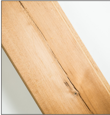
Malé praskliny na povrchu prken jsou povoleny
